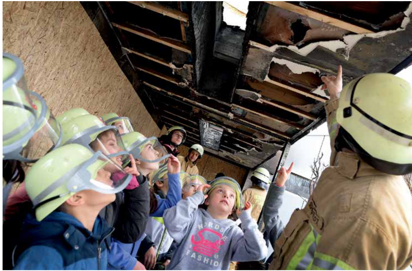
Mit eigenen Augen konnten die betroffenen Kinder das weitgehend zerstörte Kinderhaus wenige Tage nach dem Brand besichtigen.
